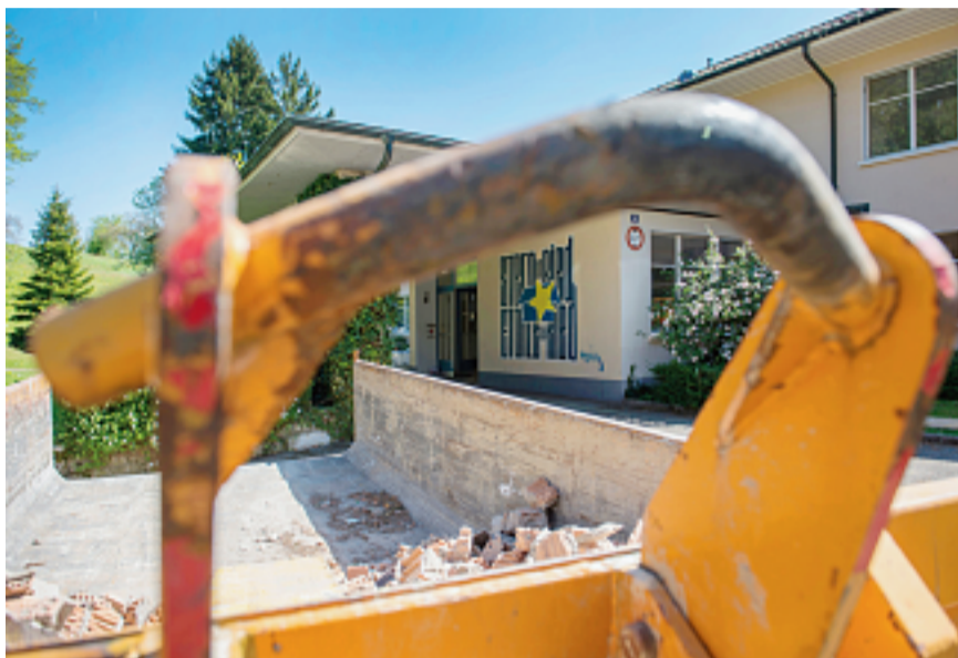
Blick durch die Baustellenmulde: Das Kinderhaus Stern im Ried am Paul-Robert-Weg in Biel wird saniert.
